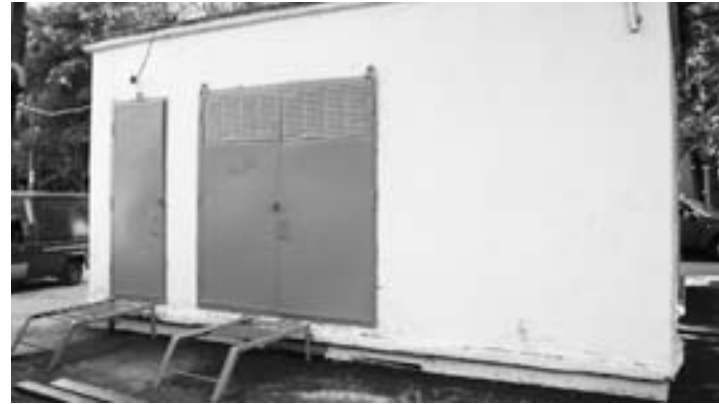
Трансформаторная подстанция на Юбилейном проспекте
